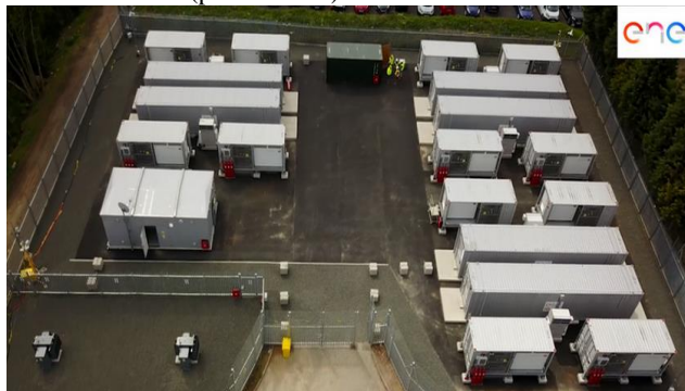
Obr. 7. BESS úložisko zložené z viacerých kontajnerov (25MW/12.5MWh, Tynemouth UK) [28]
