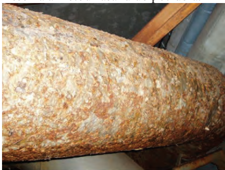
Obr. 3 Rozsiahla plošná korózia potrubia
