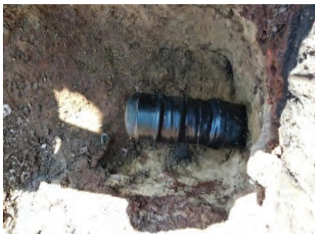
Obr. 17 Utesnenie (oprava) potrubia s priamym únikom
