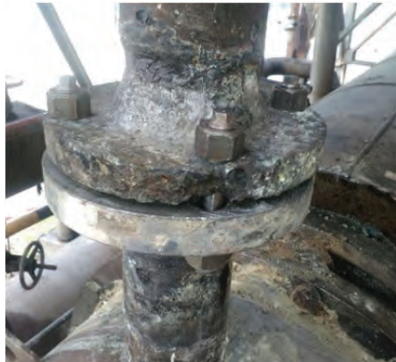
Obr. 1 Rozsiahla plošná korózia prírubového spoja
