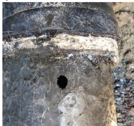
Obr. 15 Potrubie poškodené jamkovou koróziou
