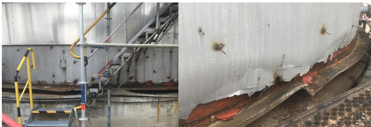
Obr. 8 Poškodenie dvojitého dna nádrže č. 2
