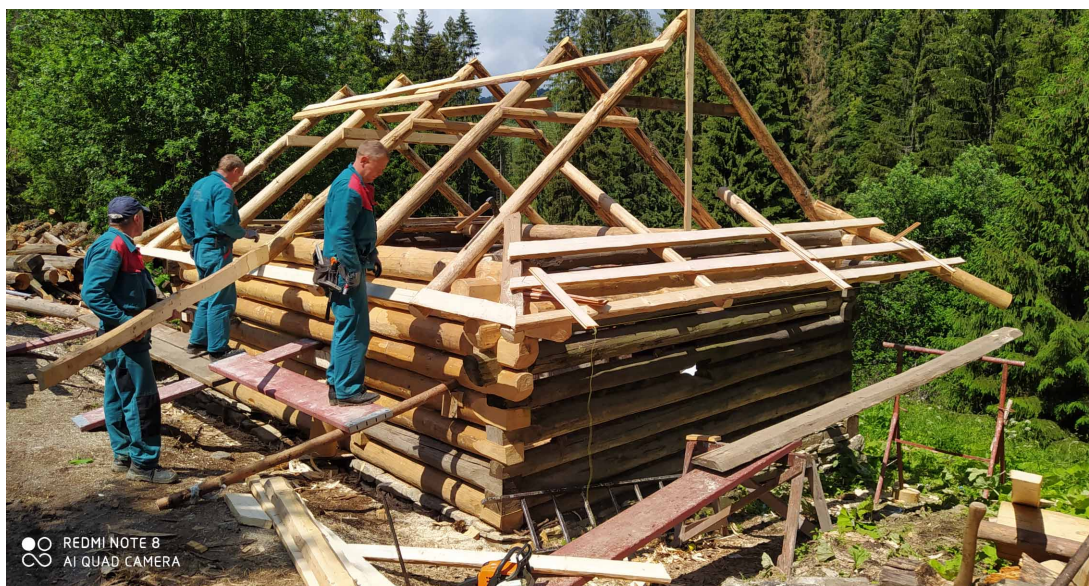
Objekt po demontáži zhnitých částí a osadení prvých drevených brvien. (Foto: Mário Janík)
