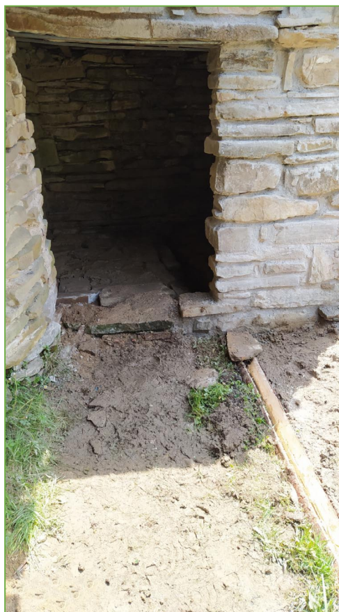
Podšalovanie poškodeného chlievu pred sanáciou v usadlosti Do potoka (foto autor)
