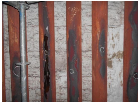
Obr.2 Spálený povrch radiačných rúr v dôsledku koksovania.
