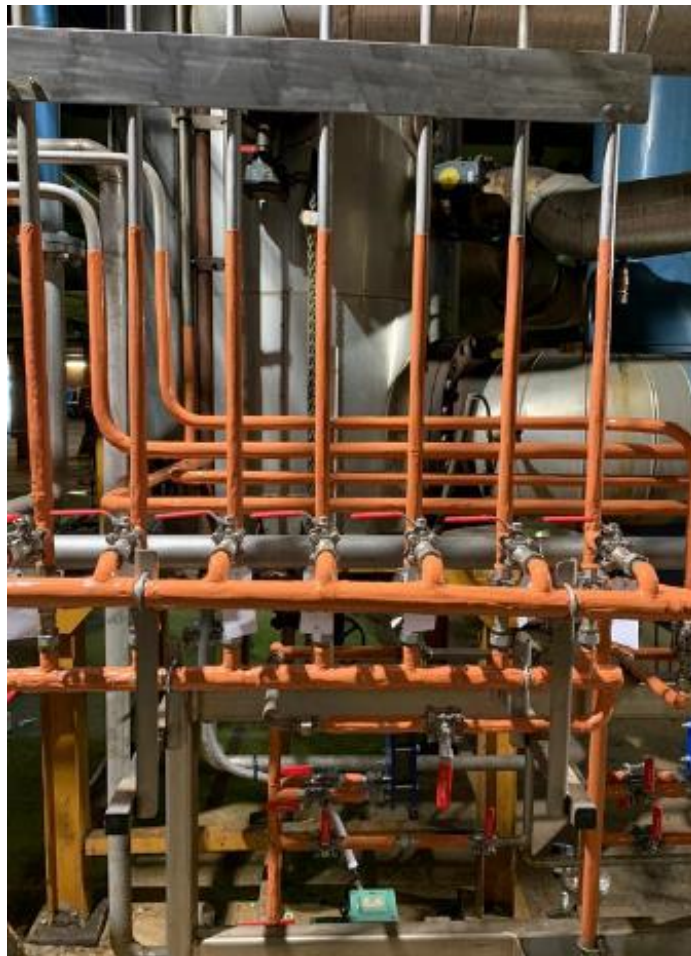
Obr. 1 Natierateľná izolácia na rozvetvenom potrubí
