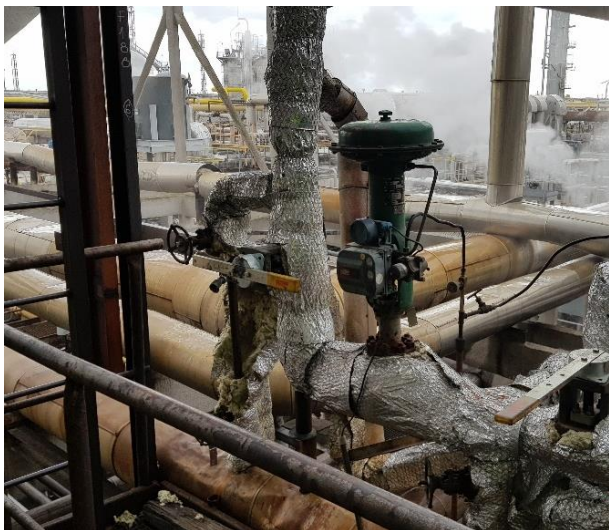
Obr.1 Poškodený uzáver prívodu kotlovej vody
