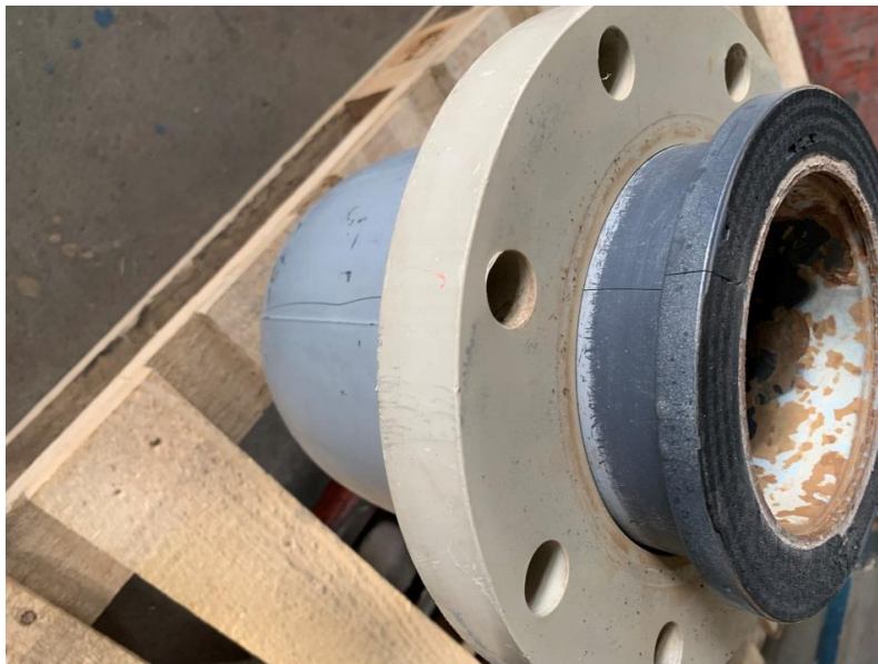
Obr. č. 6 PVC potrubie s prasklinou
