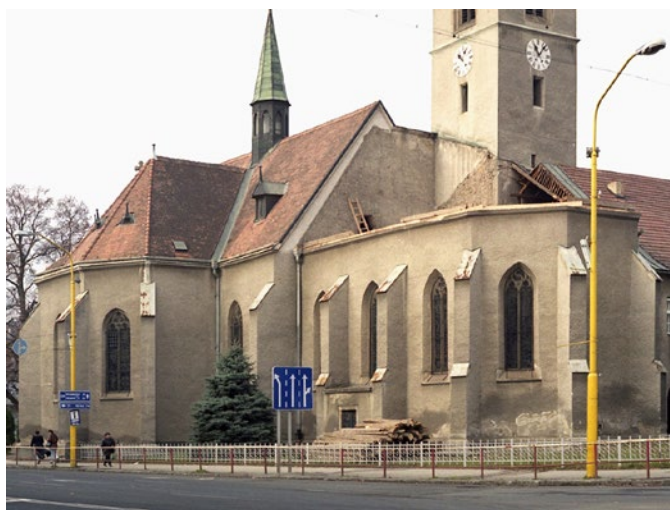
Obr. 15. Oprava krovu a strechy svätyně františkánskeho kostola v Humennom na fotografii z r. 1999. Zdroj: AKPÚ PO, f. ZN, Humenné, Rím. kat. kláštorňý kostol Všetkých svätých, neg. č. 35433-1; repro A. Liška
